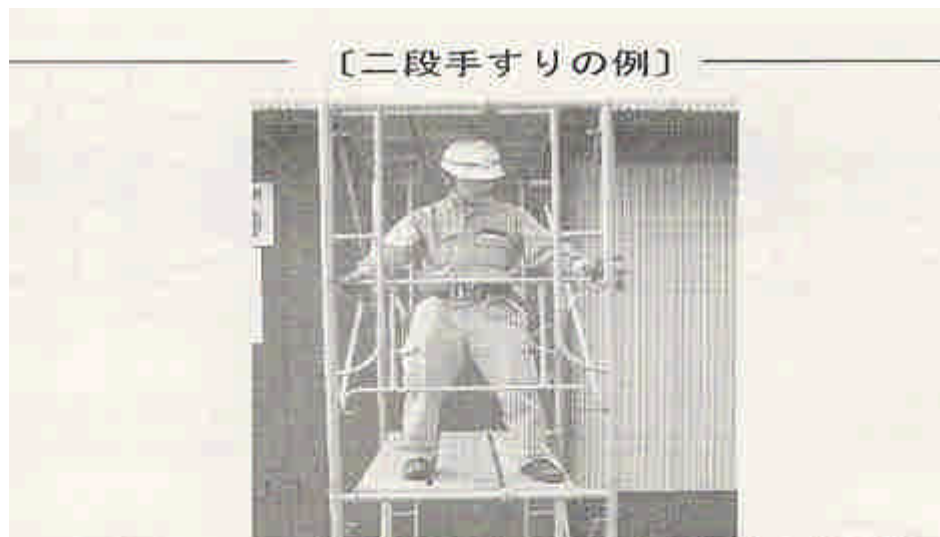
写真3-7 わく組足場用墜落防止設備の使用例
