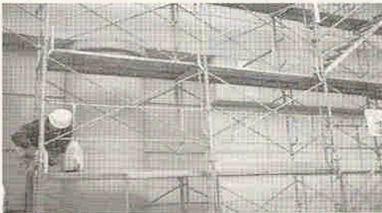
写真3-8 わく組足場用墜落防止設備の使用例
