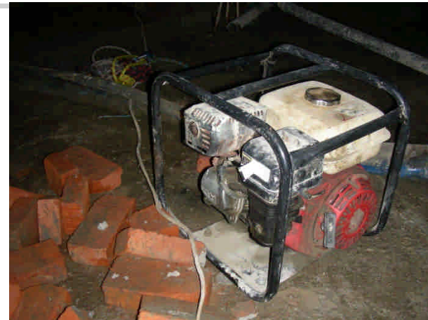
污水池機房內有內燃機之抽水機
