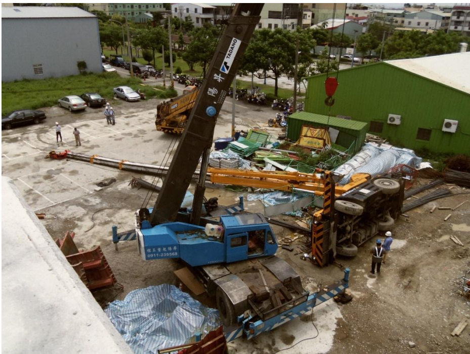
25T移動式起重機外伸撐座外展開翻覆
