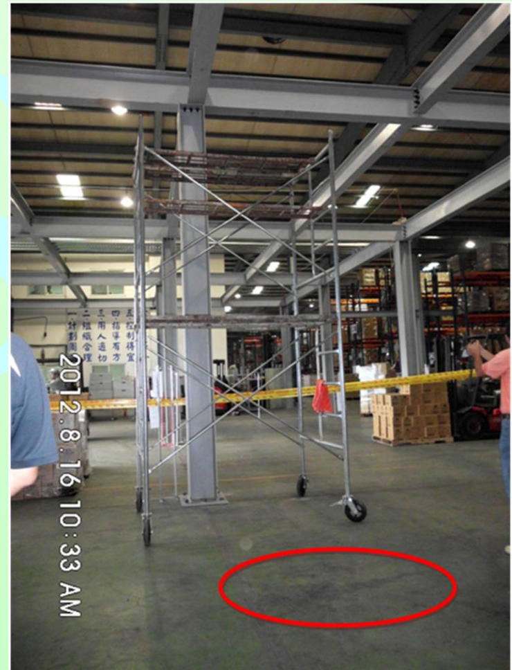
災害現場照片，罹災者所使用之施工架及墜落處。（災害發生後拍攝）
