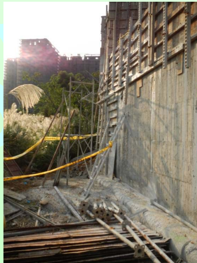
職災發生現場
