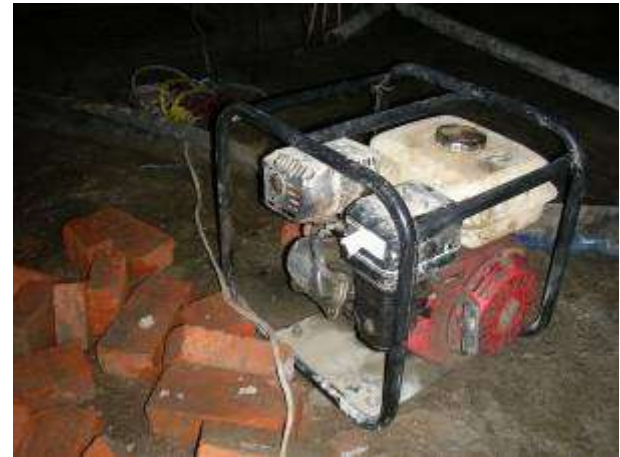
污水池機房內有內燃機之抽水機
