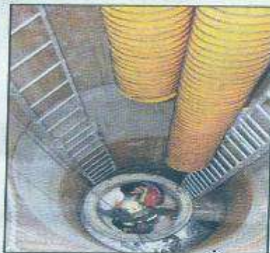
▲消防人員架起通風設備、戴上氧氣面罩，進入井底將3人救出。
