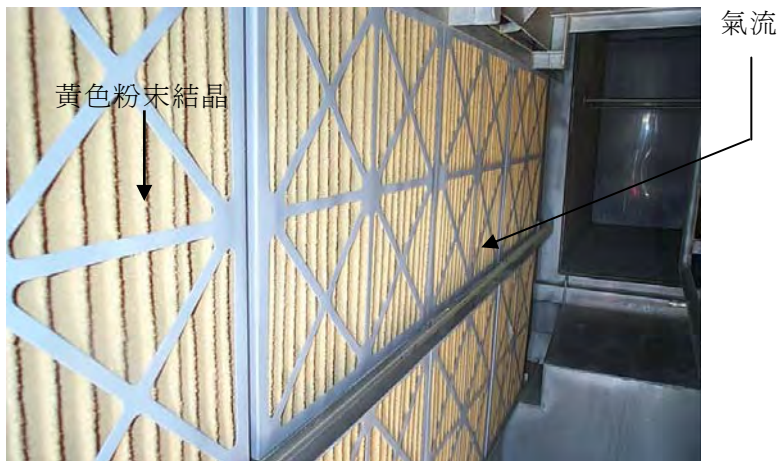
圖 3 A 廠 VOCs 濃縮轉輪焚化系統之前過濾器
