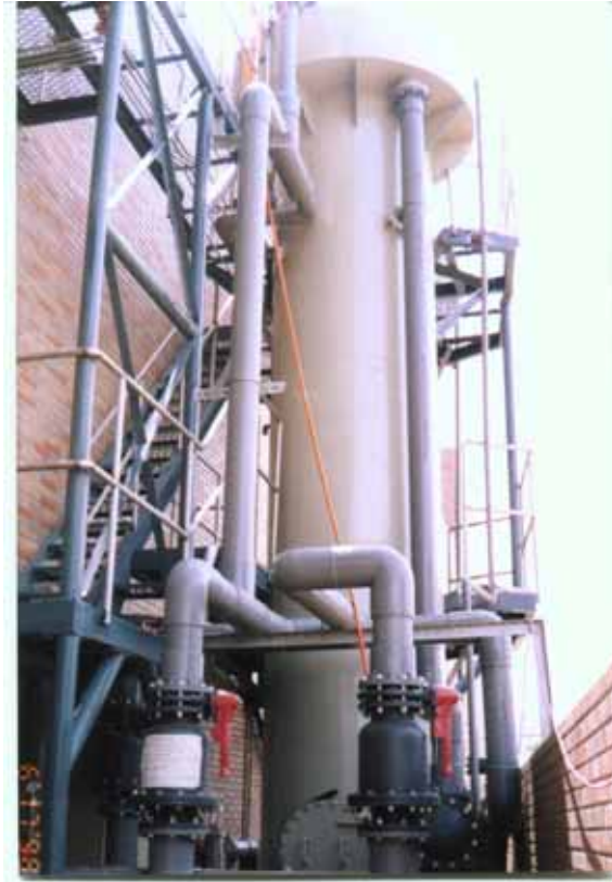
圖 5 立生半導體含氟廢水流體化床結晶槽
