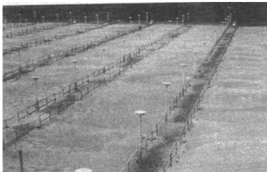
圖 6 亞特蘭大 1 座污水處理廠中浮渣覆蓋曝氣池（資料來源：Mesut Sezgin）
