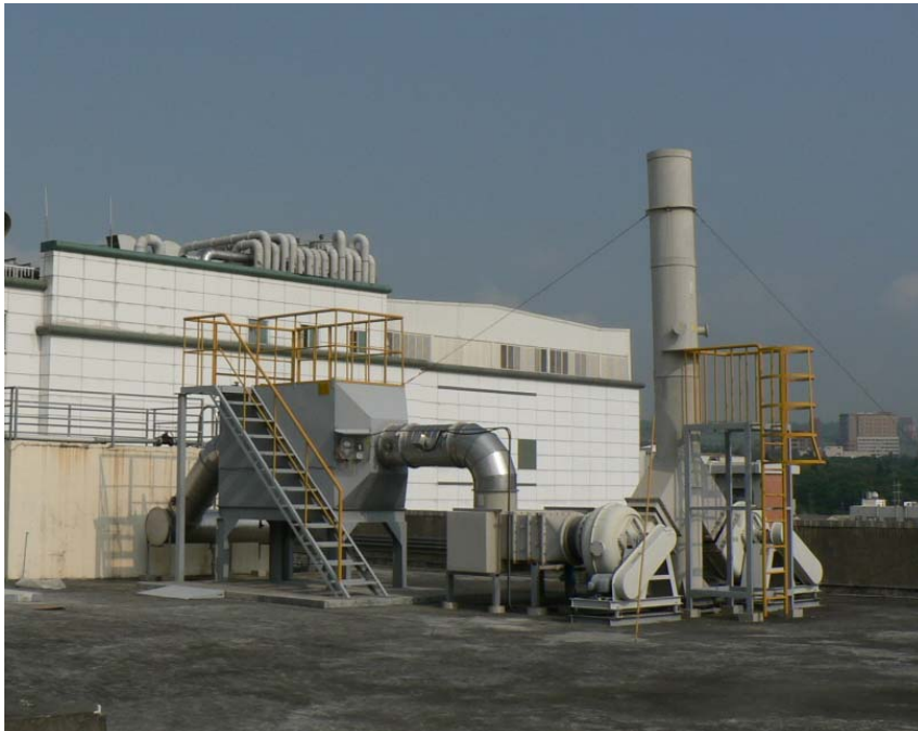
圖 2 STN 液晶顯示器製程活性碳塔設備
