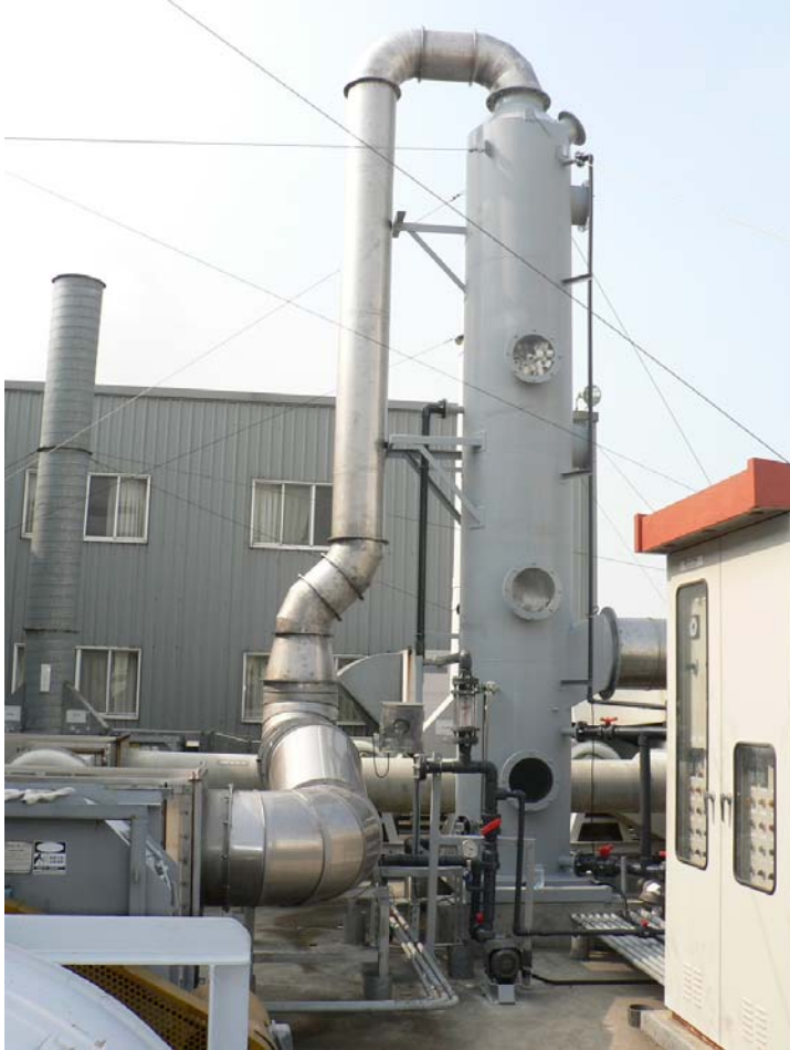
圖 3 冰水填充洗滌塔
